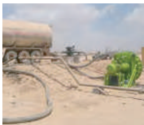
Bombeo de crudo ALH125
