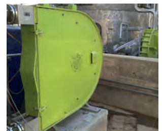
ALX150 y ALH125 para dosificación de químicos, proceso de minería
